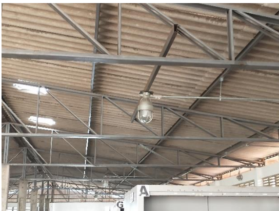
Figura 9 – Sistema de iluminação à prova de explosão
