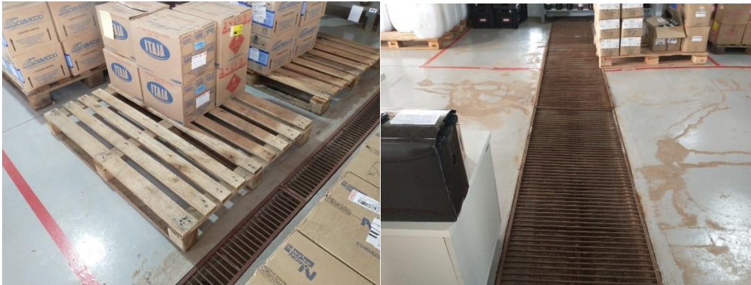
Figura 6 – Canaletas para contenção de vazamentos no interior do almoxarifado
