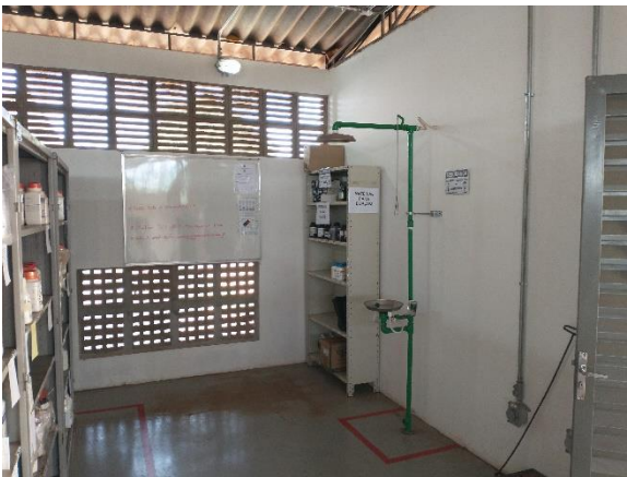
Figura 11 – Chuveiro e lava-olhos de emergência
